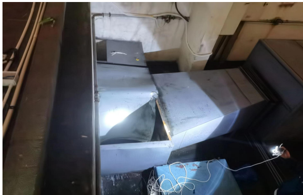
图 2 镀锌钢板风管段破损情况
